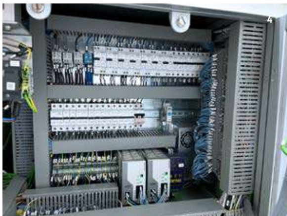
Fig. 4 Dettaglio di parte dell'impianto elettrico necessario al funzionamento di un sistema robotico. È evidente la complessità di integrazione.
